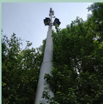
Eksempel på rørmast.
