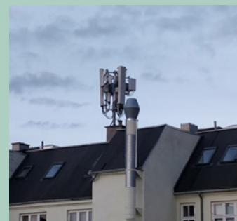
Eksempel på antenne på eksisterende bygning.
